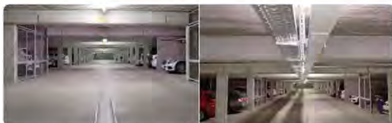
Referenzprojekt in Zorneding: Tiefgarage vor und nach Einbau der Ladeinfrastruktur, mit zentraler Deckenschiene
